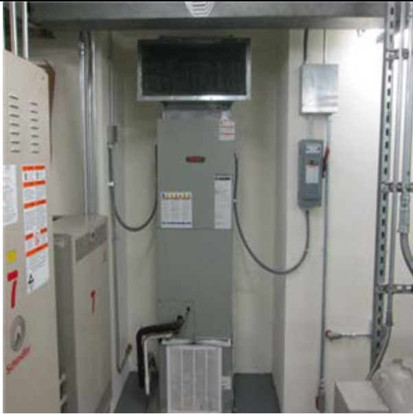
Fan Coil Unit, 5 Ton :- Fan coil unit
