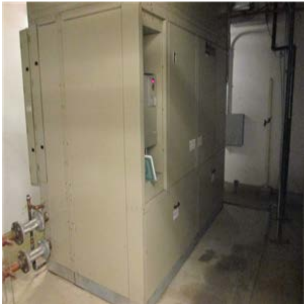
Fan Coil Unit, 40 Ton :- Self contained fan coil
