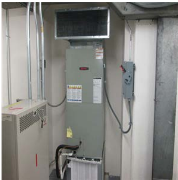
Fan coil unit
