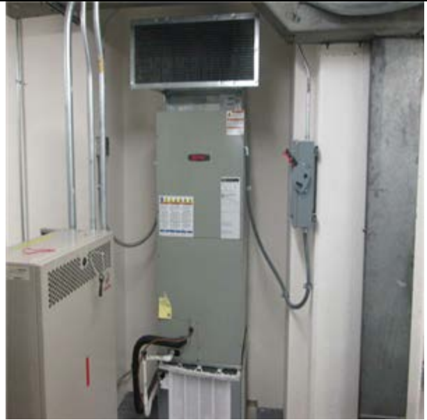
Fan Coil Unit, 5 Ton:- Fan coil unit
