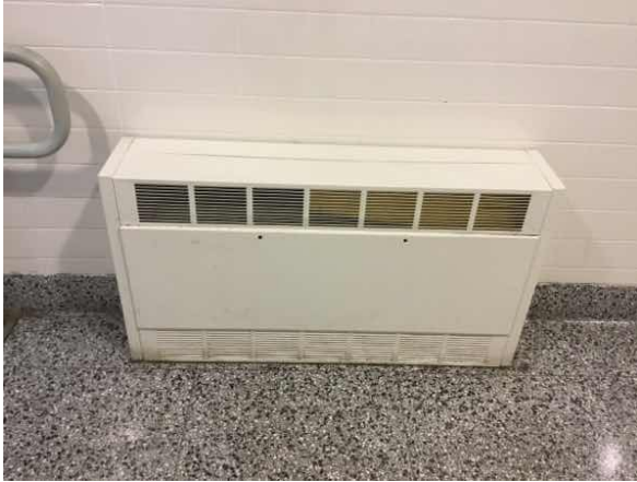
Fan Coil Unit
