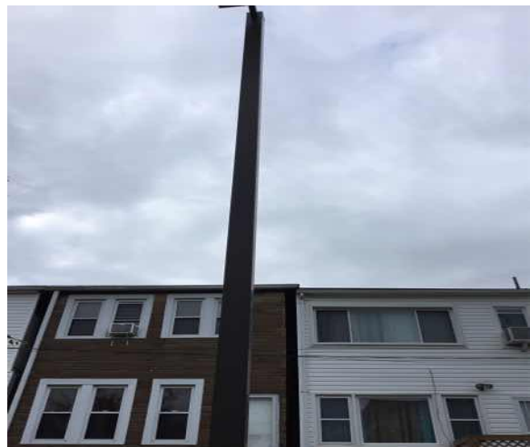
G4022 Poles:- Site Light Pole
